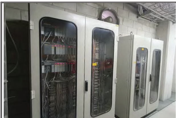
- FMC - SALA DOS INVERSORES E PLC DA MISTURA -
