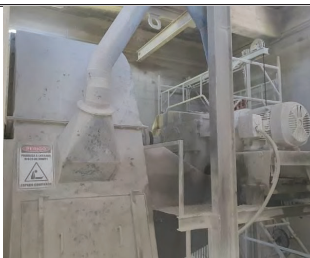
- FMC - ELEVADORES EC 707 DA DESCARGA DE VAGÕES EC 708 DA MISTURA-
