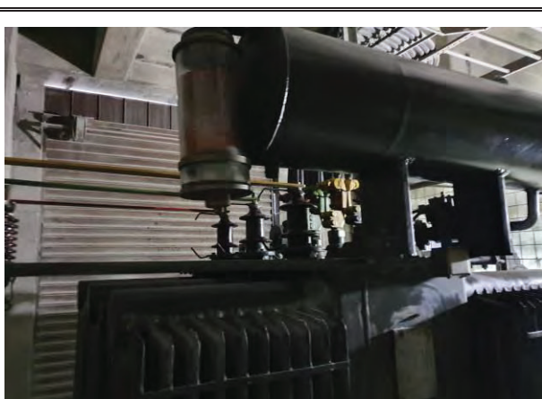
- FMC - TRANSFORMADOR DE 1000 KVA, 13,8 KV E SUBESTAÇÃO -
