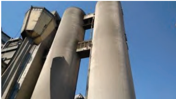
- FPS - SILOS DE HOMOGENEIZAÇÃO -
