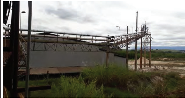
- QUATIS - TORRE DE PRODUTO FINAL -
