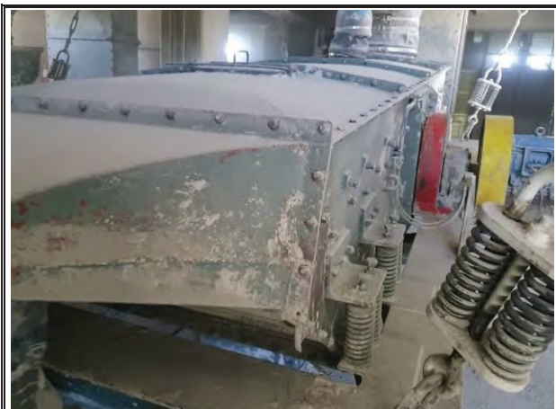
- FMC - PENEIRAS 233 DO CIMENTO ENSACADO E 234 DO CIMENTO GRANEL -
