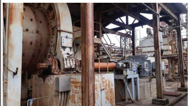
- QUATIS - MOINHO DE BARRAS E MOTOR 450 CV -
