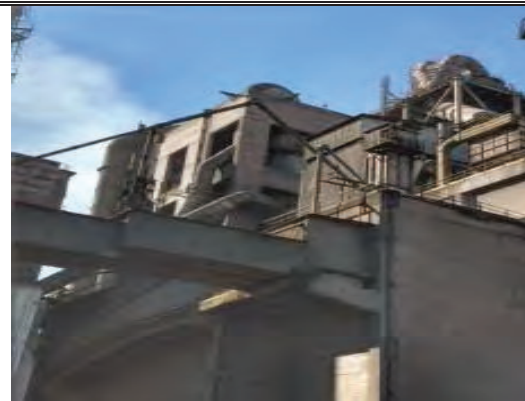
- FPS - TORRE DE ARREFECIMENTO DO ELETROFILTRO ELEX -
