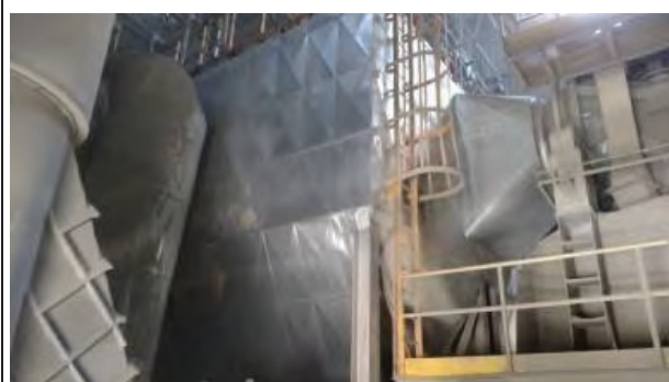
- FPS - FILTRO DE MANGAS - DESEMPOEIRAMENTO DO SEPARADOR -
