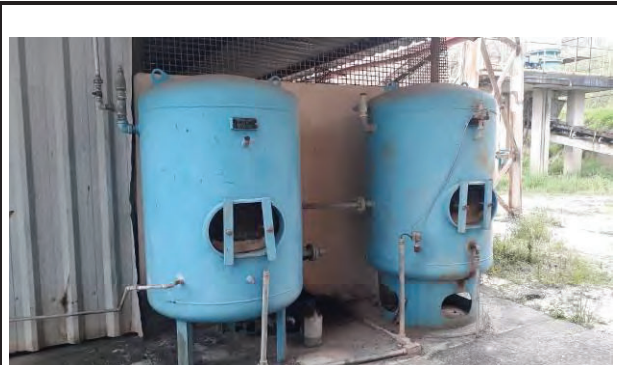
- QUATIS - SILO DE AR -
