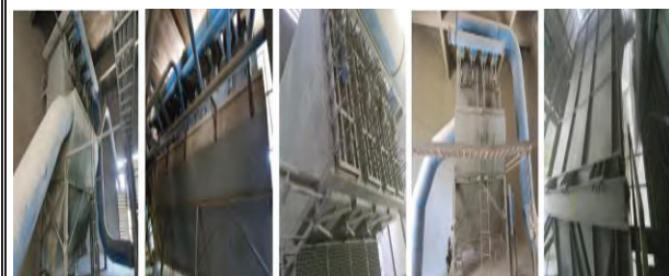
- FMC - FILTRO E156 DESPOEIRAMENTO DOS SILOS 3 E 4 FILTRO; C146 DESPOEIRAMENTO GRANEL E ENSACADEIRA, ENTRE OUTROS -
