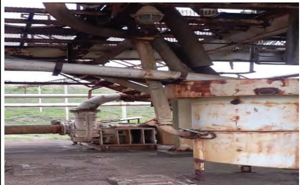
- QUATIS - BOMBA DE POLPA 06 -
