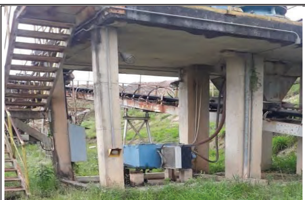
- QUATIS - CAIXA DE LUBRIFICAÇÃO DO BRITADOR CÔNICO -
