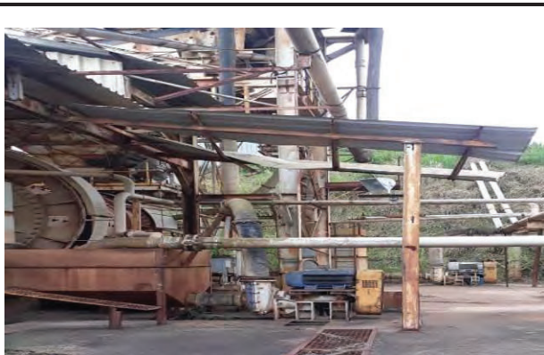
- QUATIS - BOMBA DE POLPA 01 E 02 -
