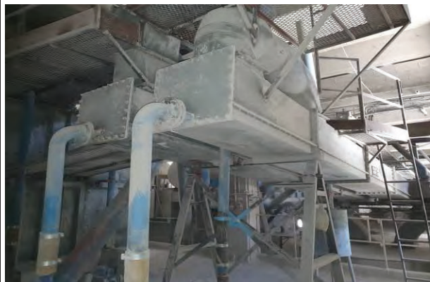
- FMC - SISTEMA DE TRANSPORTE GRANEL APÓS PENEIRA E FOTO DOS PRÉ-SILOS -
