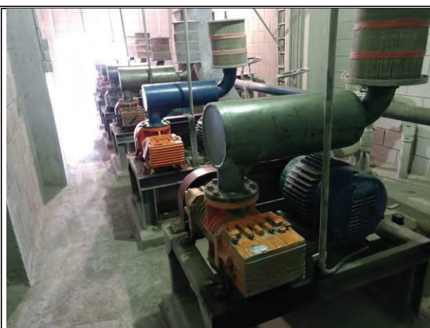
- FMC - COMPRESSORES ATLAS COPCO GA 22 E GA 310 E SALA DOS SOPRADORES -
