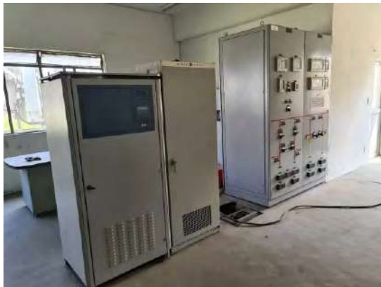
Imagens 34, 35 e 36 – Subestação elétrica da unidade de Volta Redonda / RJ
